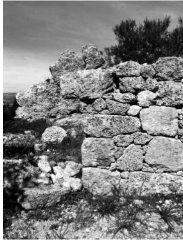
Piramide di Cerumbelle: Particolare di un tratto di muro danneggiato
