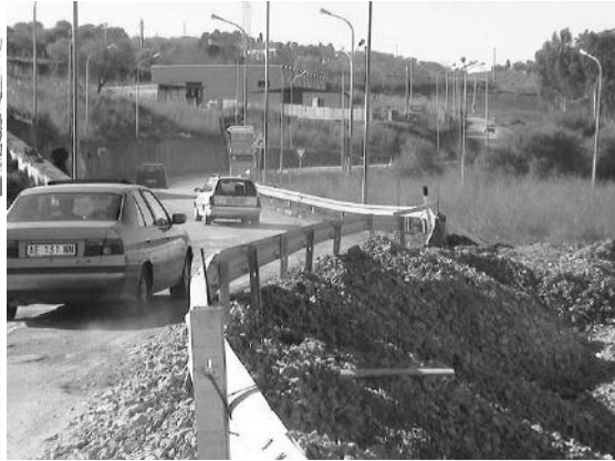
La grossa frana all'ingresso dello svincolo della Veloce Pietraperzia-Caltanissetta.
