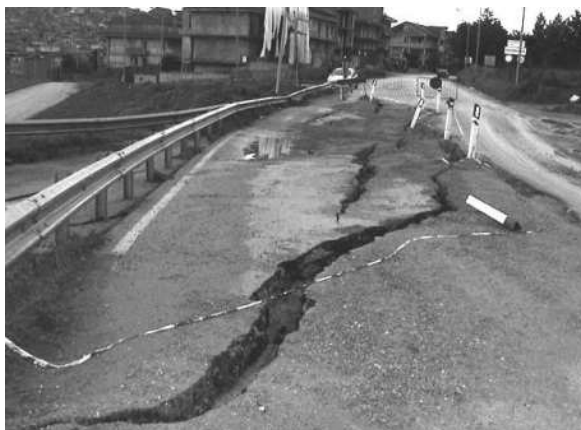
La frana in contrada San Gisippuzzu
